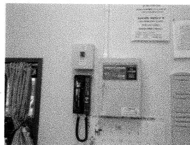
消防機関へ通知する 火災報知設備
